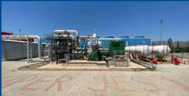
Un impianto geotermico di Exergy in Turchia da 12 MWe per Kipas Holding
