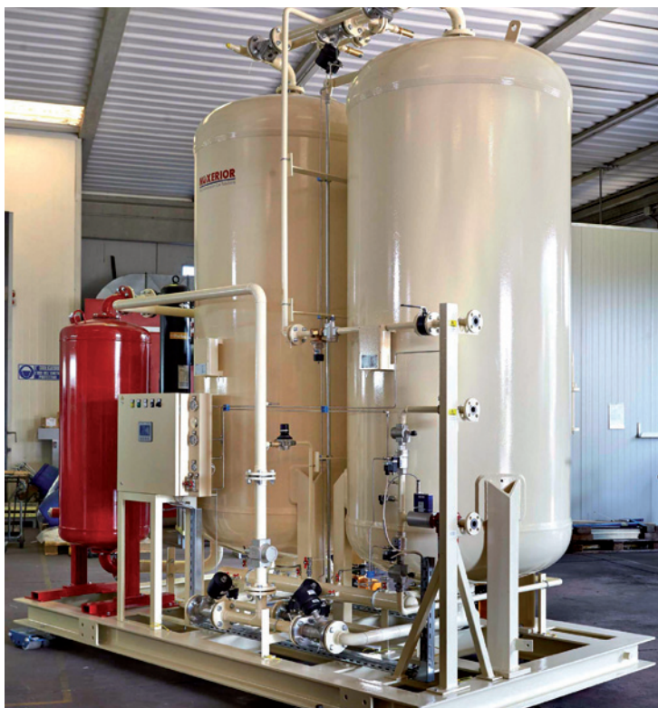
Skid di impianto per produzione di ossigeno (processo PSA)
