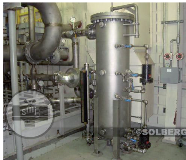
Oil Mist Eliminator Solberg in un impianto Petrochimico
