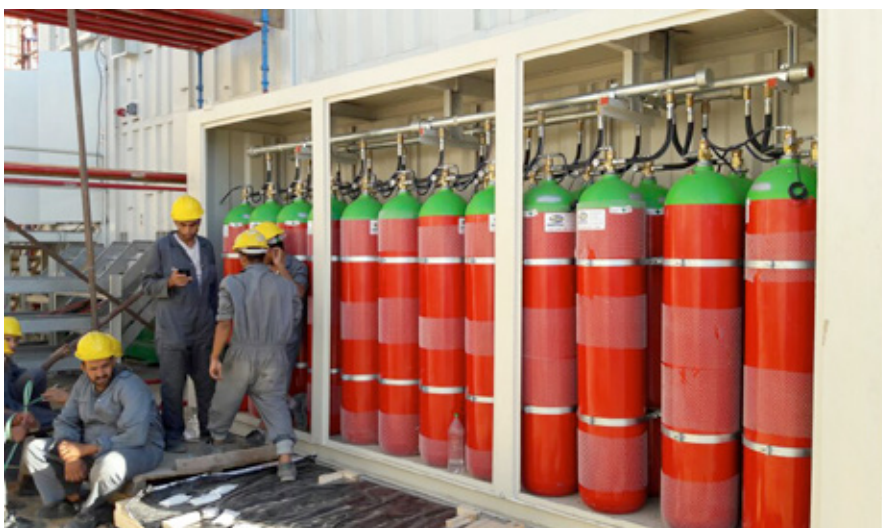
Fig.4 - Skid bombole antincendio
