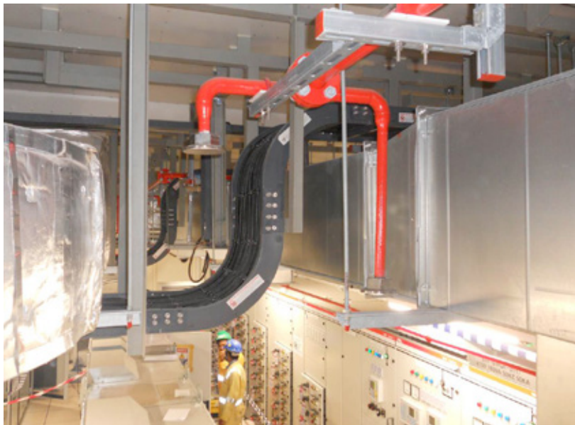
Fig.1 - Interferenze (Hard Clash) tra impianto di spegnimento a gas -NOVEC e sistema HVAC
