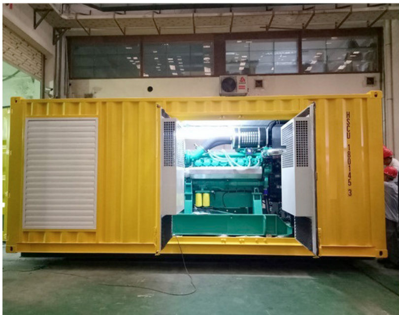
Fig. 2 - Serrande di ventilazione in gruppo elettrogeno
