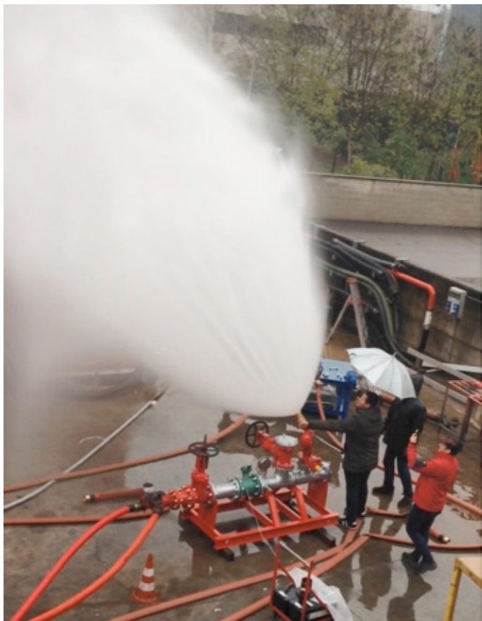
Fig.6 - Collaudo monitor antincendio
