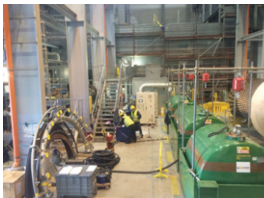
Manutenzione grandi impianti
