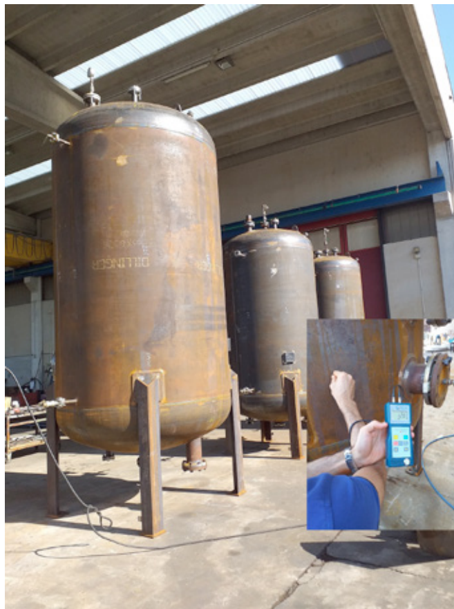
Fig.7 - Collaudo idrostatico serbatoi antincendio
