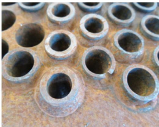
Figura 5 - Esempio estremità tubo danneggiata
